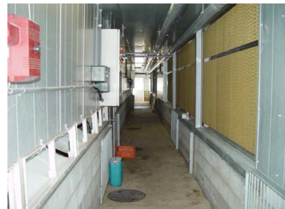
通路外側に設置
